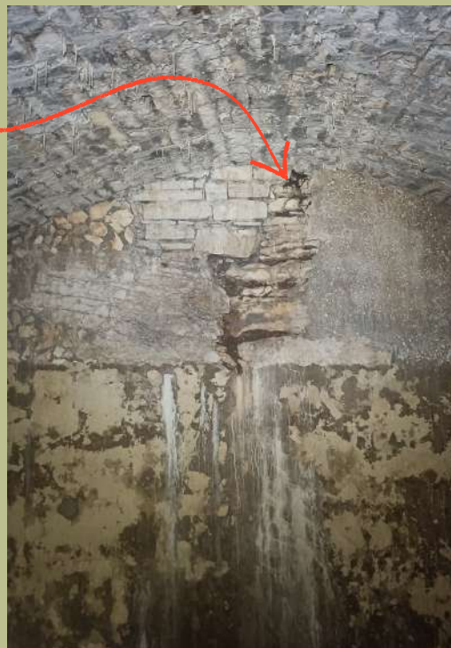
24. Particolare di un punto di sconnesione sul lato est della cisterna
