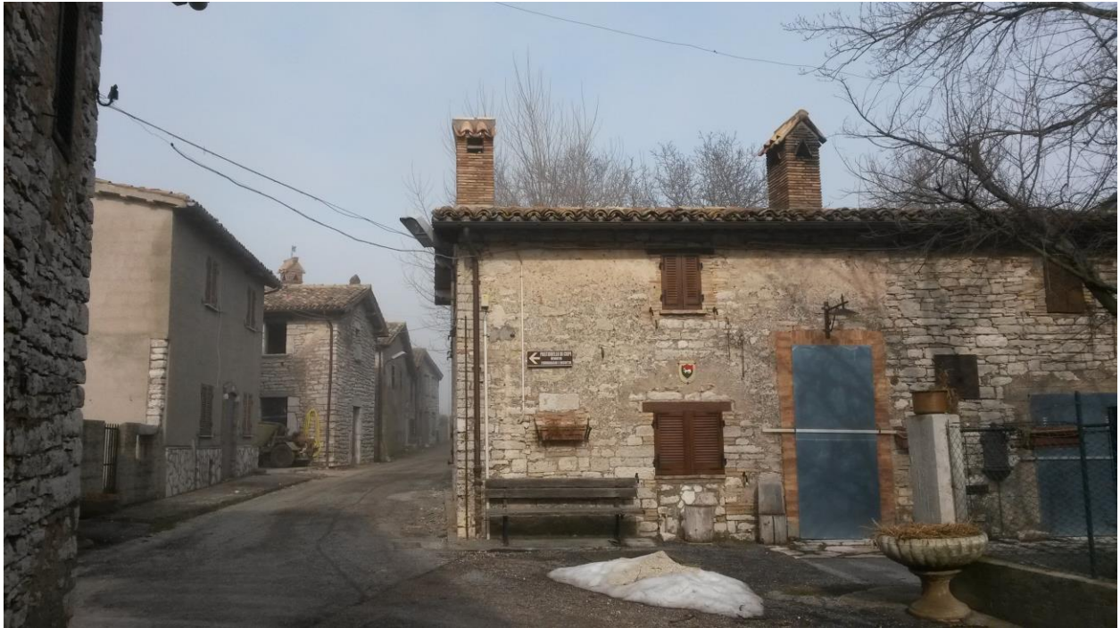
Frazione di Visso – le case hanno resistito esternamente ma all'interno sono crollate
